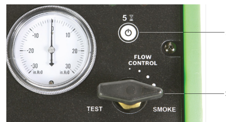
Fig. 9: Le régulateur de flux de fumée est intégralement ouvert
